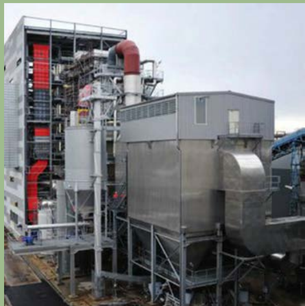
Kogeneracijska naprava v Metzu (Francija) kot vir energije uporablja odpadno biomaso. Z elektriko oskrbuje 300.000 gospodinjstev.
