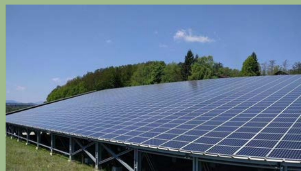
Leta 2020 so v Sloveniji postavili 3.947 novih sončnih elektrarn v skupni moči 55 megavatov (60 % več kot leta 2019).
