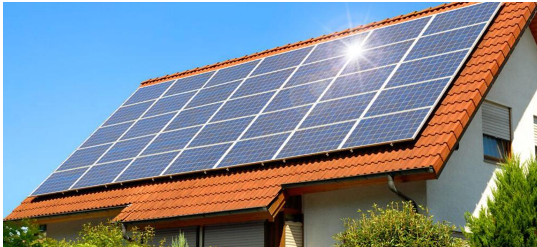
mala sončna elektrarna na strehi
